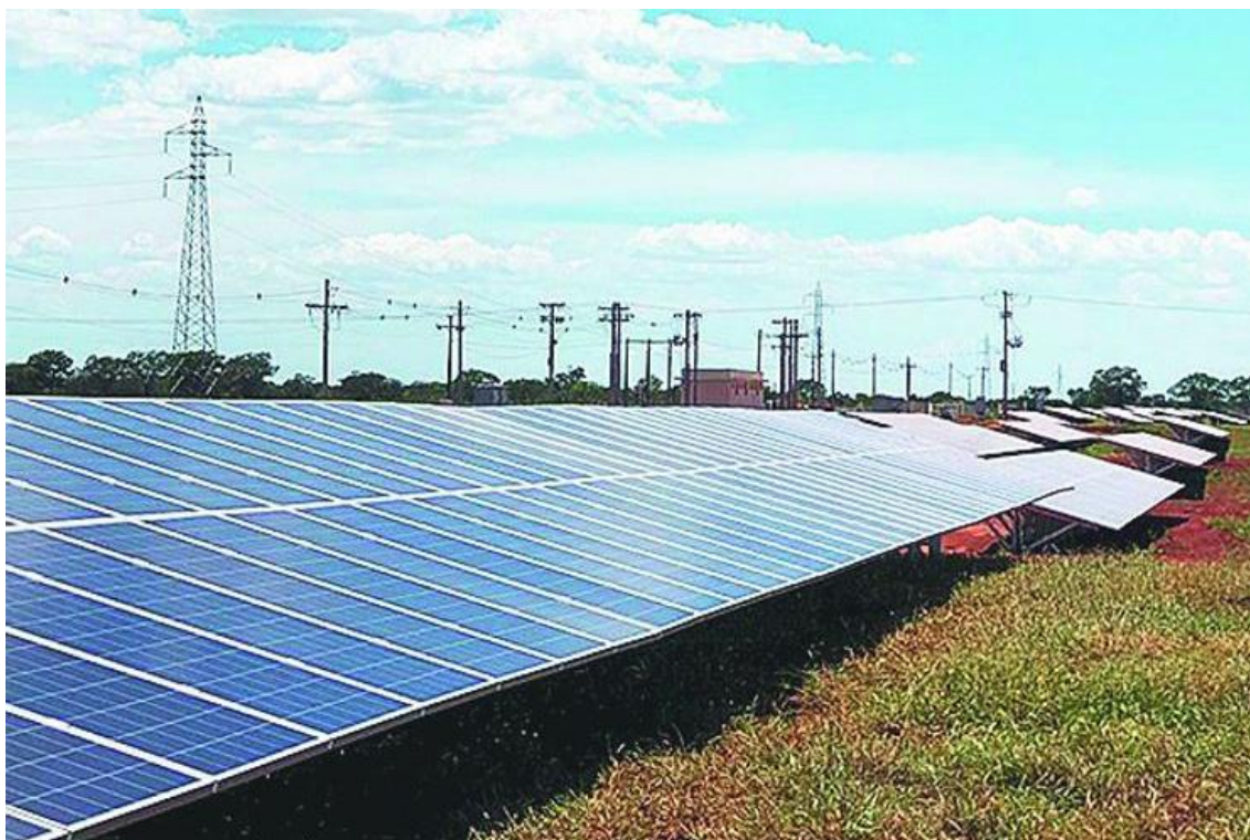
Figura 2.2: Primeira usina fotovoltaica da CEMIG, localizada em Janaúba-MG.
