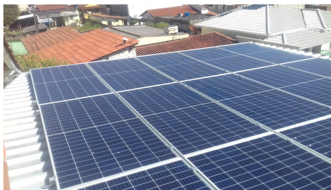
Figura 3.3: Sistema Instalado com estruturas fixas sobre o telhado - Planta A
