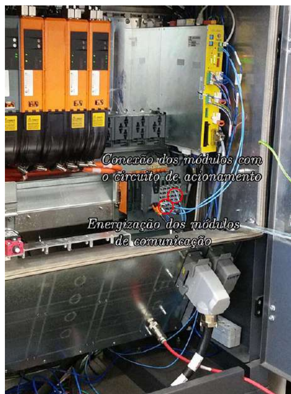
Figura 3.16b: Conexões realizadas na controladora
