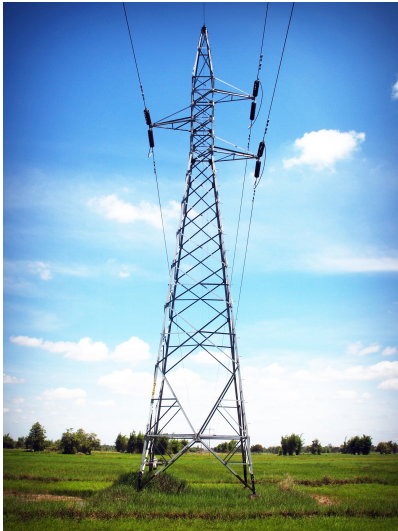
(a) Estrutura de disposição triangular. Fonte: < https://pixabay.com/photos/power-electricity-line-ylon-1549115/ >. Acesso em: 22/3/2020.
